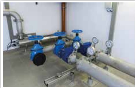
Ein Blick in die Pumpstation in Maxhofen – im Hintergrund der Edelstahl-Körper der UV-Anlage
